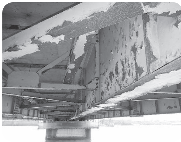
▲腐食した橋桁
