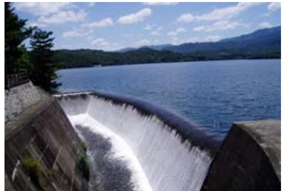
写真2：洪水吐 (香川県HPより)
