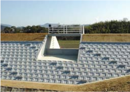
写真1：洪水吐 (香川県HPより)
