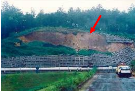
写真 37：堤体付近の法面(崩壊後)
